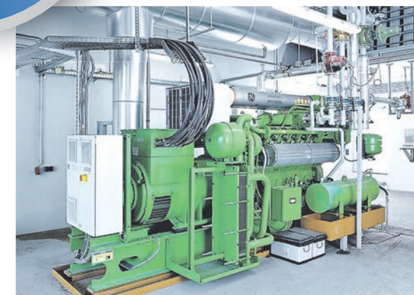
Innio Jenbacher - Blockheizkraftwerk 635 kW elektr.
